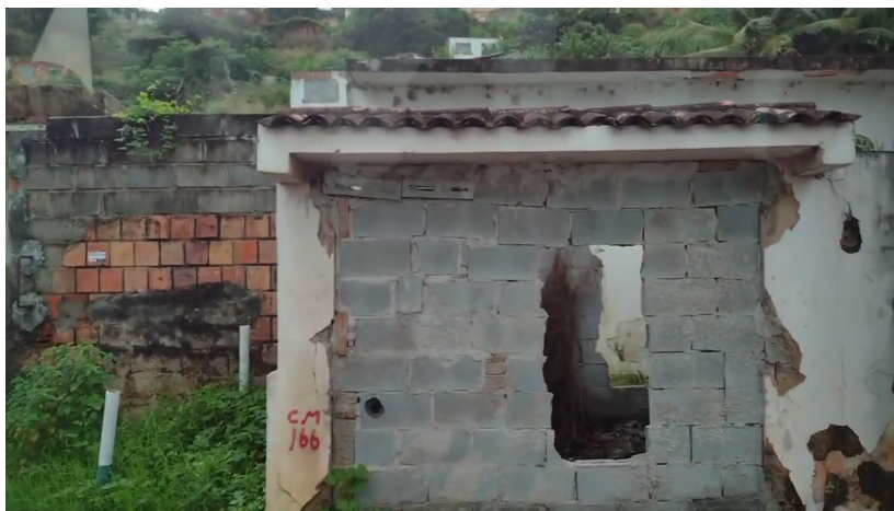
Imagem 3 - Casa desocupada em área de risco de desabamento no bairro Mutange
