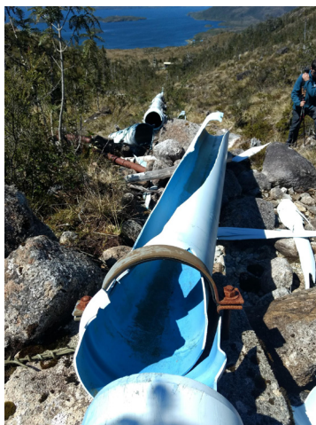
Figura 3. Rotura de la tubería alimentadora de la turbina hidroeléctrica.
