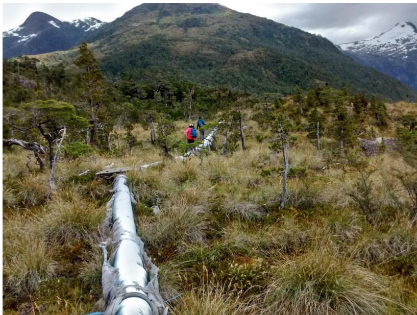
Figura 2. Caminando sobre la tubería, quedando atrás del ritmo de María Isabel.
